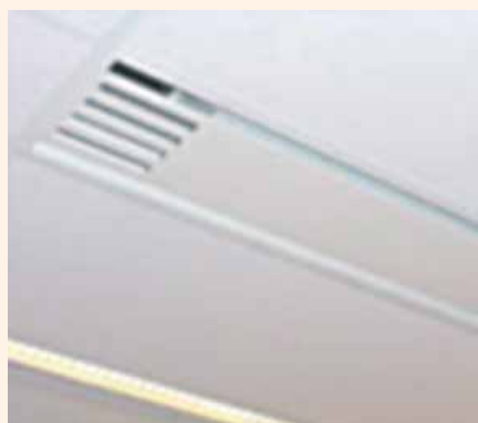
Soffitto a travi fredde
